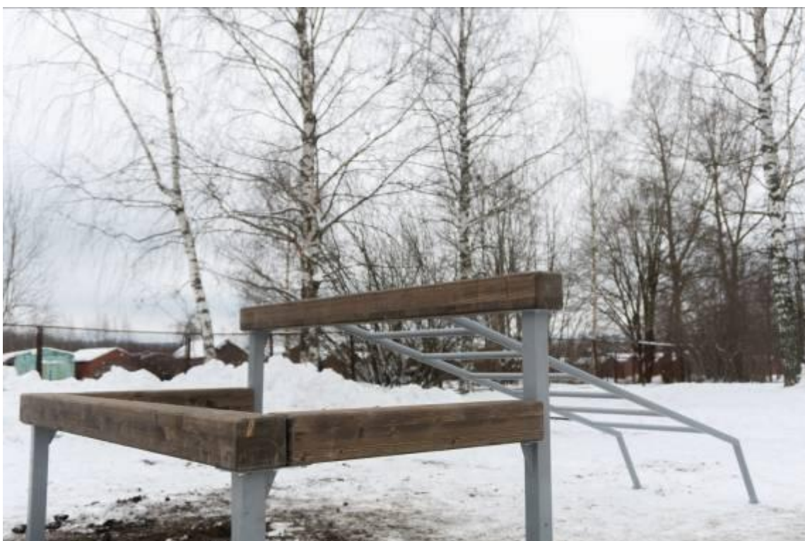
Фото 9. Полоса препятствий ПП-02 (Разрушенная лестница)
